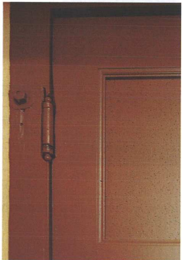
Drzwi D1. – widoczny bardzo zły stan zachowania płyciny z miękkiego drewna liściastego zaatakowanej przez ksylofagi.
