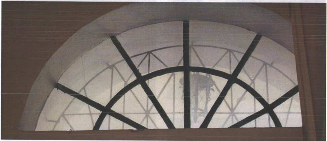
Nadświetle drzwi Dz1, widok z zewnątrz i wewnątrz, współczesne szklenie i najprawdopodobniej metalowa rama z II. poł. XX w.
