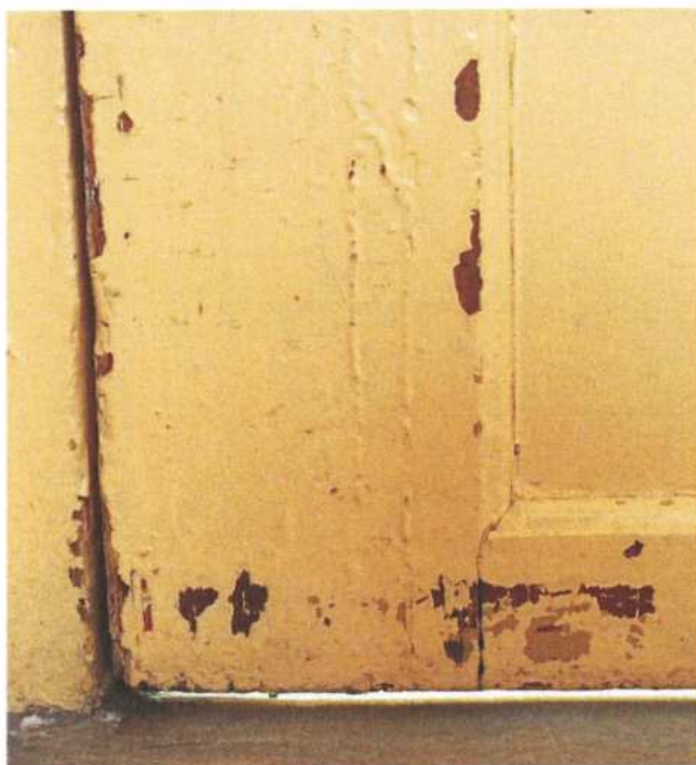
Drzwi D3 – dolny fragment z widocznym przycięciem, łuszcząca się i odpajająca warstwa farby.
