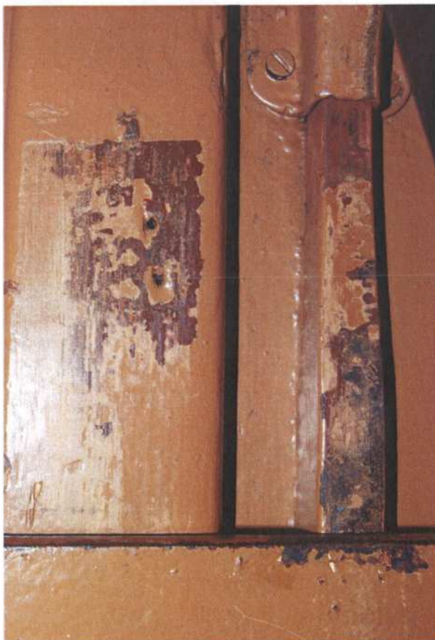
Rewers drzwi Dz1, widać brak zielonej warstwy farby na listwach.
