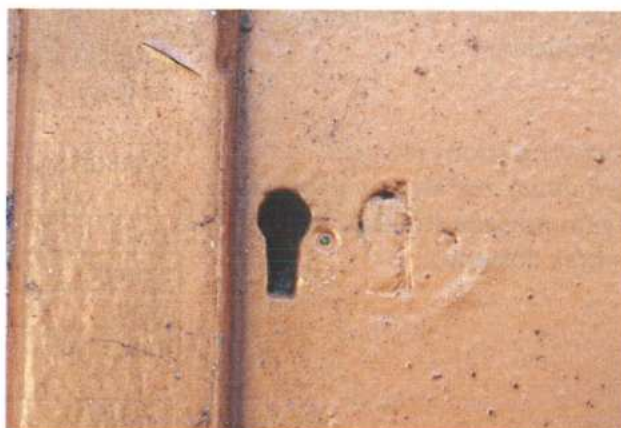
Awers drzwi Dz2a – otwór wtórny od zamka oraz obok zaślepiiony wcześniej otwór z owalnym szyldzikiem.
