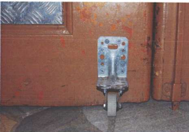
Drzwi D1. – wtórne elementy okuć – kłódka, kółko oraz poziomy rygiel.
