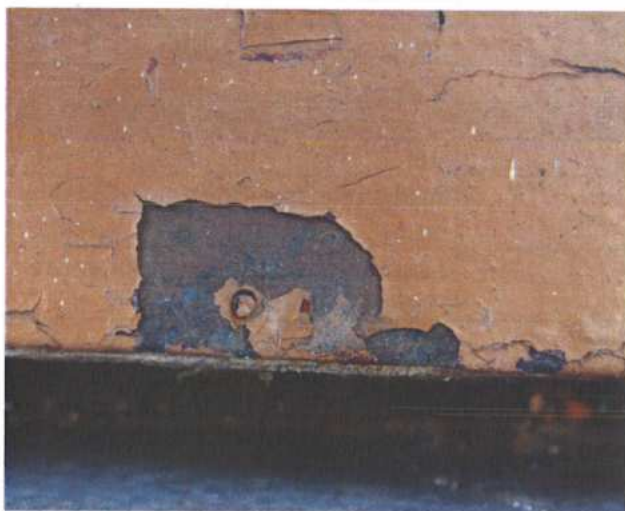
Ubytek warstw farby na kopniku, przy dolnej krawędzi drzwi. Widoczny skorodowany metal.
