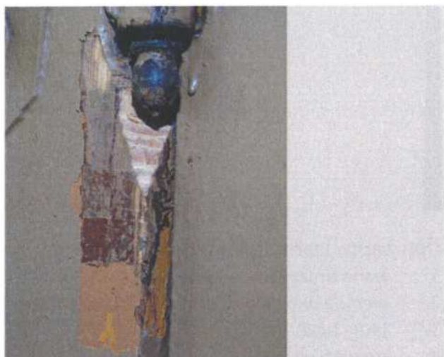
Odkrywka D1.1 ościeżnica przy zawiasie po zewnętrznej stronie drzwi
