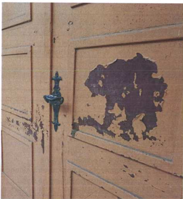
Awers drzwi Dz2a – widoczne łuszczące się warstwy wtórnej farby.
