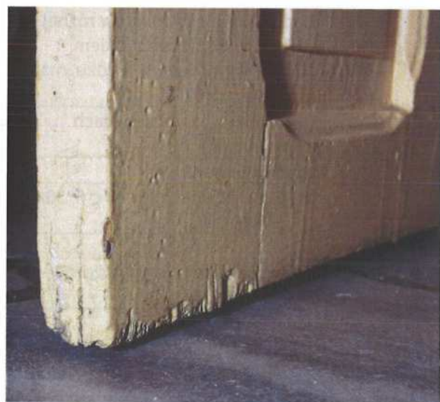
Drzwi D5, uszkodzenia mechaniczne w dolnej części drzwi.
