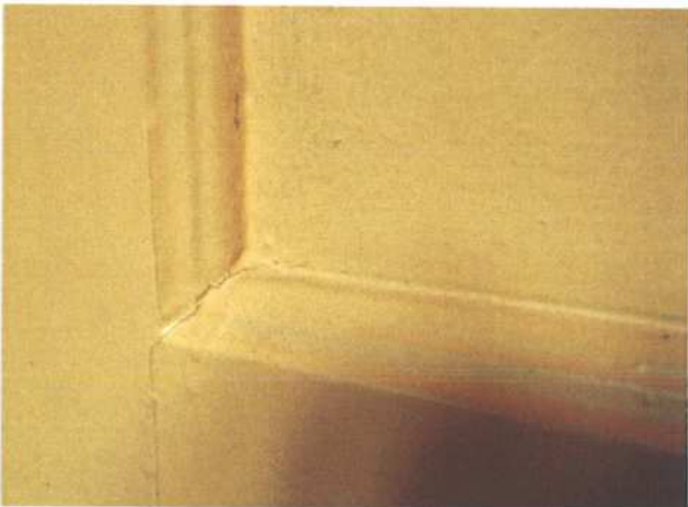
Drzwi D4, spękana i odspajająca się warstwa przemalowania.
