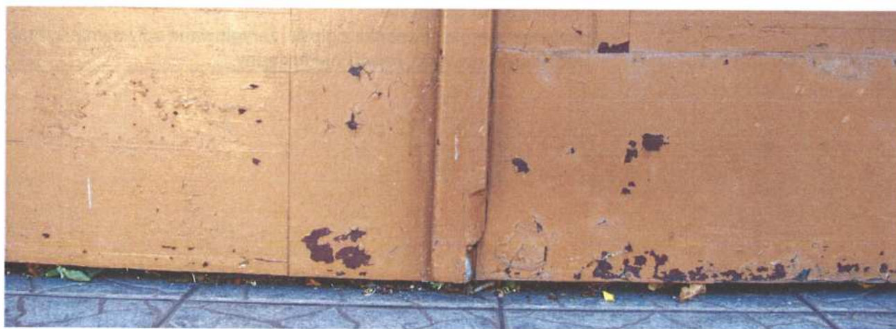
Awers drzwi Dz2a – dolny fragment z kopnikiem oraz łuszczącymi się i wykruszonymi warstwami przemalowania.
