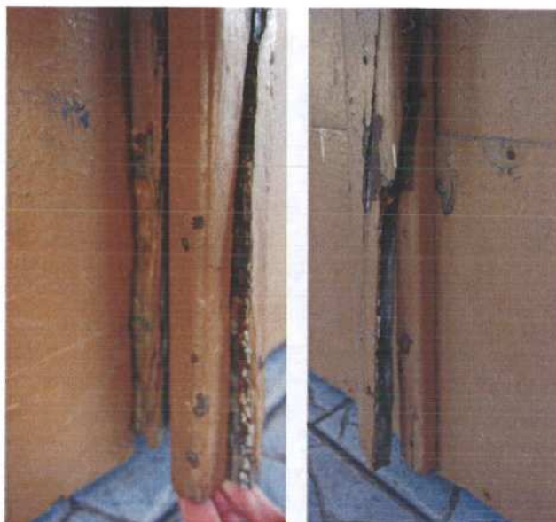
Drzwi Dz2b – uszkodzenia listwy przymykowej w dolnej partii.
