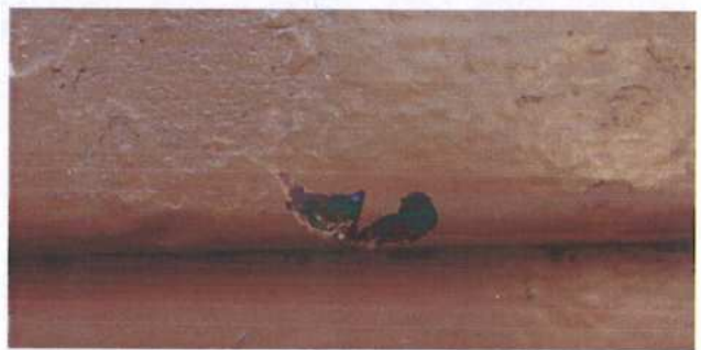
Awers drzwi Dz1. widoczna zielona farba na listwach obramienia płycin.
