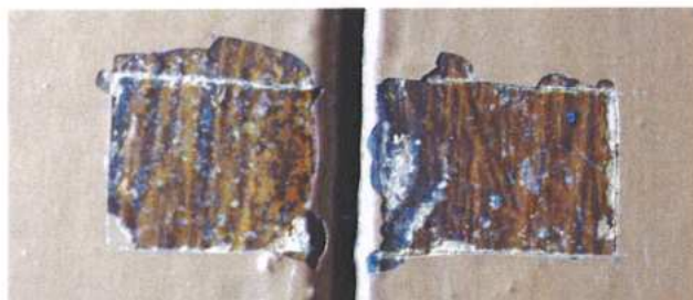
Odkrywka D2b.4 awers rama po zewnętrznej stronie drzwi
