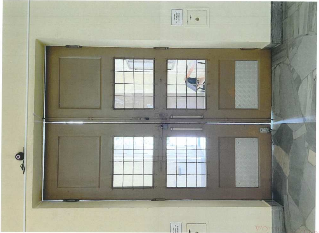
fot. 18.1 - drzwi wahadłowe D1
