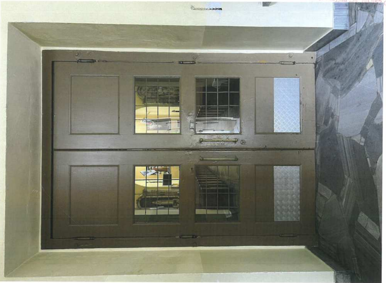
fot. 18 - drzwi wahadłowe D1
